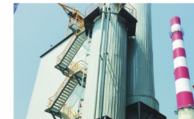
杭州杭联热电
