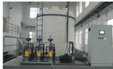
广州市花都区狮岭污水处理厂 设计污水处理规模为7万m 3 /天，采用AAO+矩形周进周出二沉池+V型滤池+紫外线消毒处理工艺
