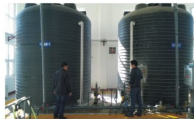
天津北辰区大双污水处理厂 设计规模为12万立方米/日，先期日处理规模达到4万立方米/日
